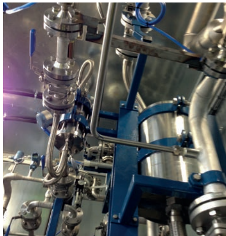
Abb. 10: Zweistufige Membrananlage für die Abtrennung von CO_2 aus Rauchgas (Bild: T. Brinkmann, Hereon).
