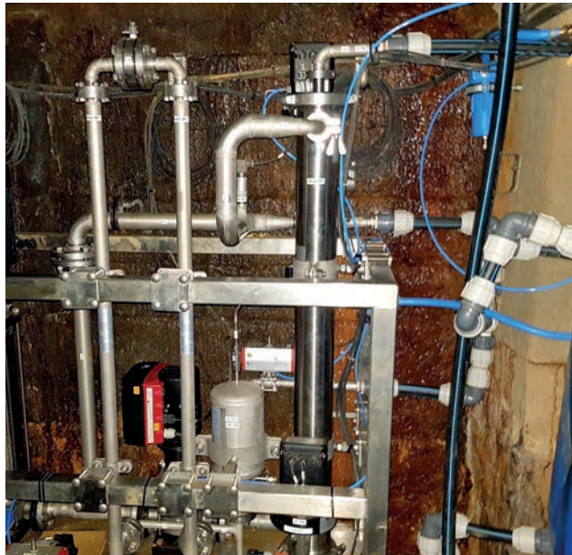
Abb. 11: On-site-Membrananlage, 1. Sohle Forschungsbergwerk „Reiche Zeche“ Freiberg (146 m Tiefe) (Bild: TU Bergakademie Freiberg, ITUN).
